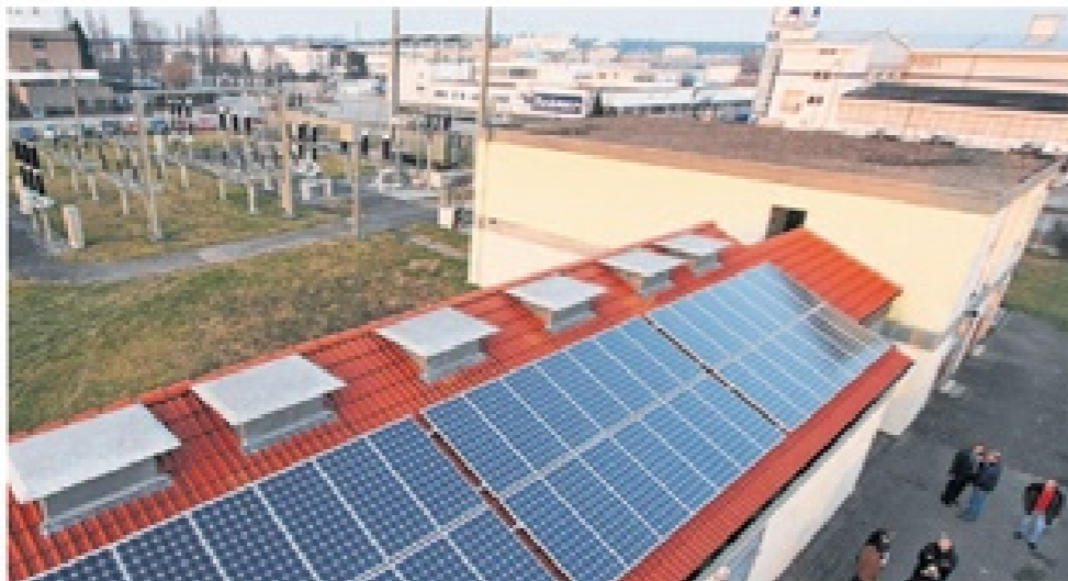
Modul neben Modul: Auf dem Dach der Umspannungstation des Umspannwerks in Hockenheim-Talhaus installiert die Stadtwerke eine Photovoltaikanlage. Eine weitaus größere ist jetzt am Hockenheimring geplant. BLD. LENHARDT
